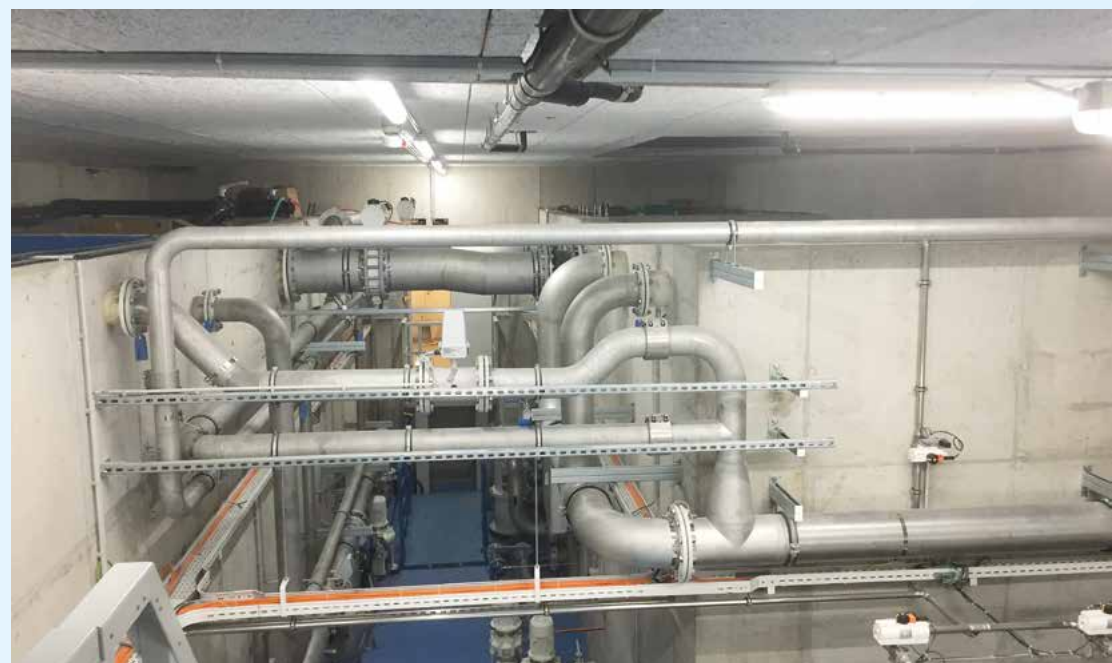
Deel van de Pharmafilterinstallatie. (Foto: Erasmus MC)
